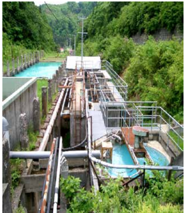
吉乃鉱山（横手市）坑廃水処理施設
