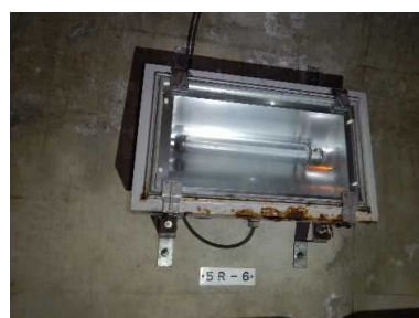
田代峠トンネル 照明灯
