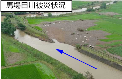
井川被災状況
