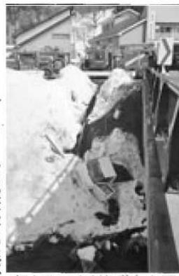
プを設置していたが、事故直後はパイプが外れていた。
