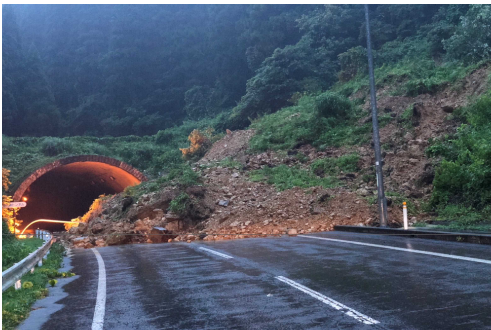
田代峠トンネル坑口付近の土砂流出（秋田市・由利本荘市境）
