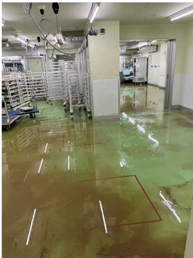
浸水した中通総合病院（秋田市南通みその町）
