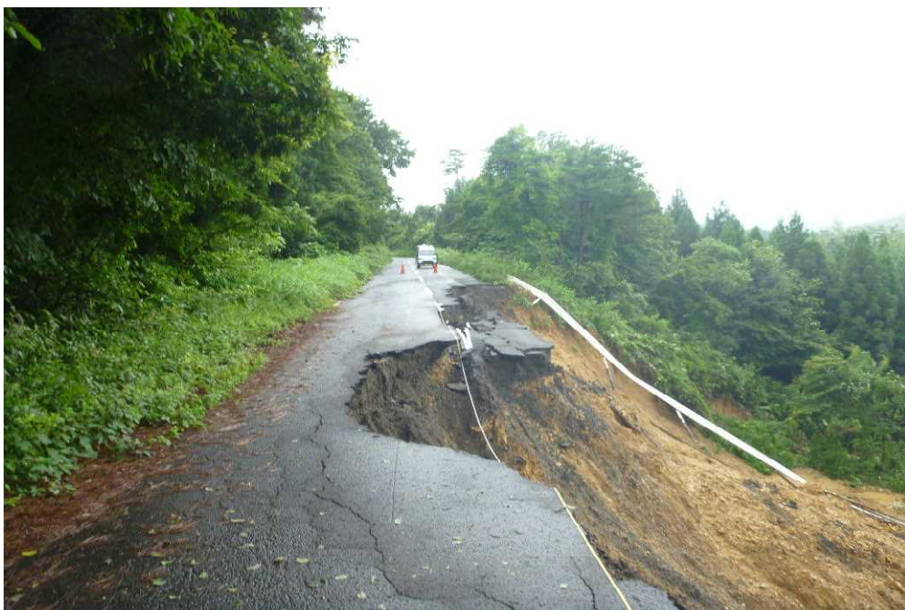
林道の路体崩壊（能代市久喜沢）
