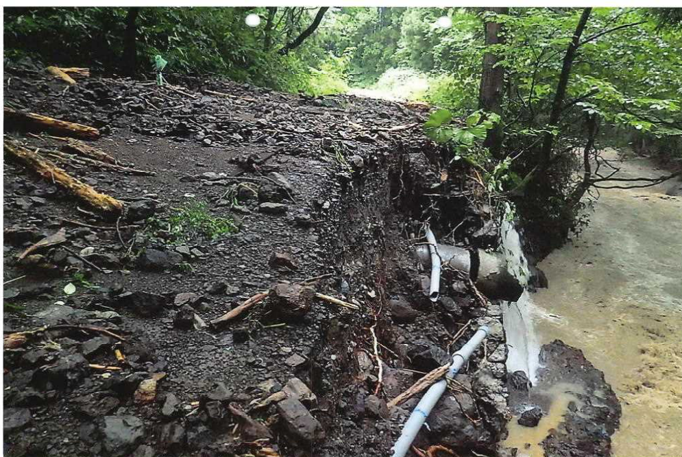
破損した導水管（八峰町八森）
