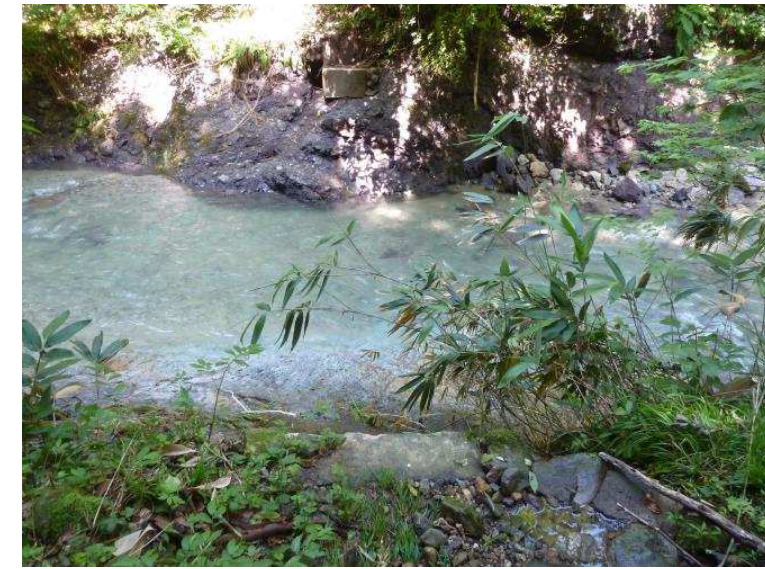
旭舞登山道 丸舞1号橋落橋状況
