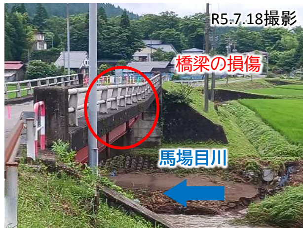
被災後の状況
