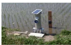
写真1：スマート田んぼダム自動排水栓
