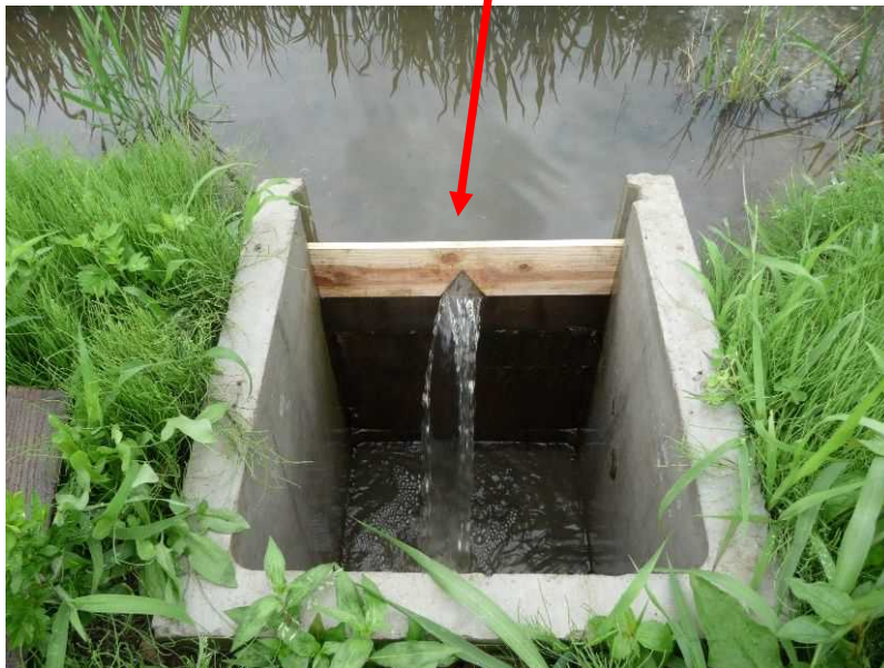
【図表 3-4： 機能一体型の場合（写真：大潟村内 設置事例）】
