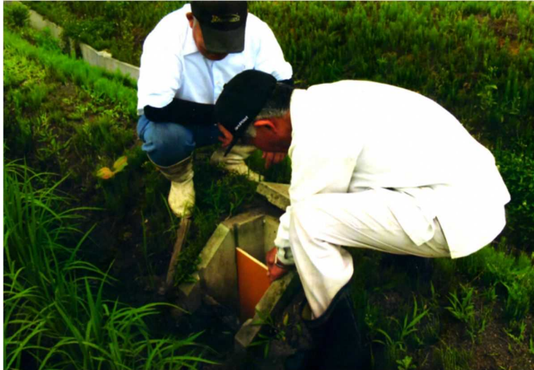
【写真 3-2：田んぼダムの設置状況 提供：齊内地区（秋田県田沢疏水土地改良区）】
