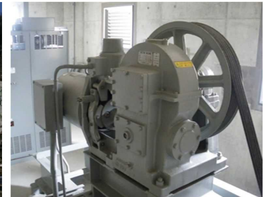
昇降設備（制御盤、巻上機）改良等 平成10年設置（24年経過）
