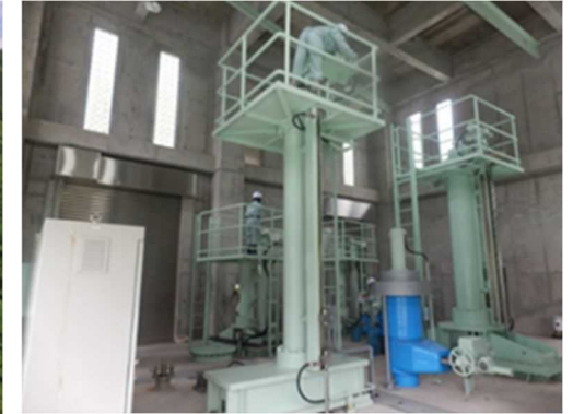
放流設備（油圧シリンダ）改良等 平成2年設置（32年経過）
