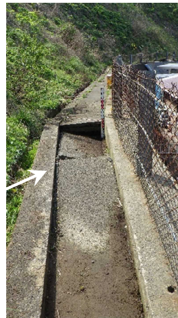
擁壁背面の沈下
