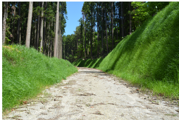
林業専用道 大工焼山沢支線 湯上市 幅員 3.6m 開設延長 680m
