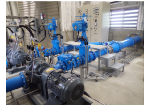
〔高野尻揚水機(北秋田市)〕
