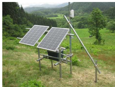
【ソーラー発電による基地局動作】
