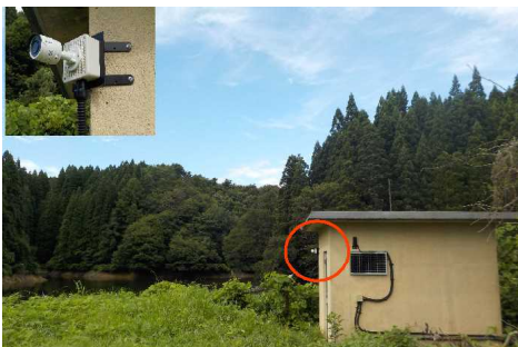
【ため池の水位観測システム導入事例（秋田市）】
