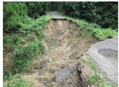
【林道の崩落（北秋田市）】
