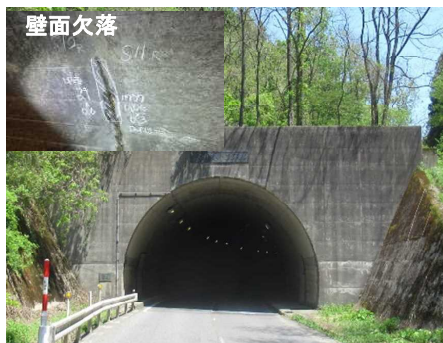
壁面欠落 (国道285号 大館市) 板戸越トンネル
