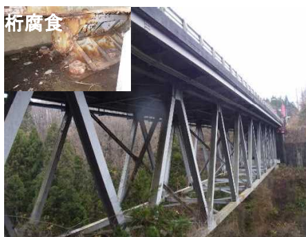
朽腐食 (秋田空港線 秋田市) 小友沢橋
