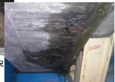
▼鉄筋が露出した床版
