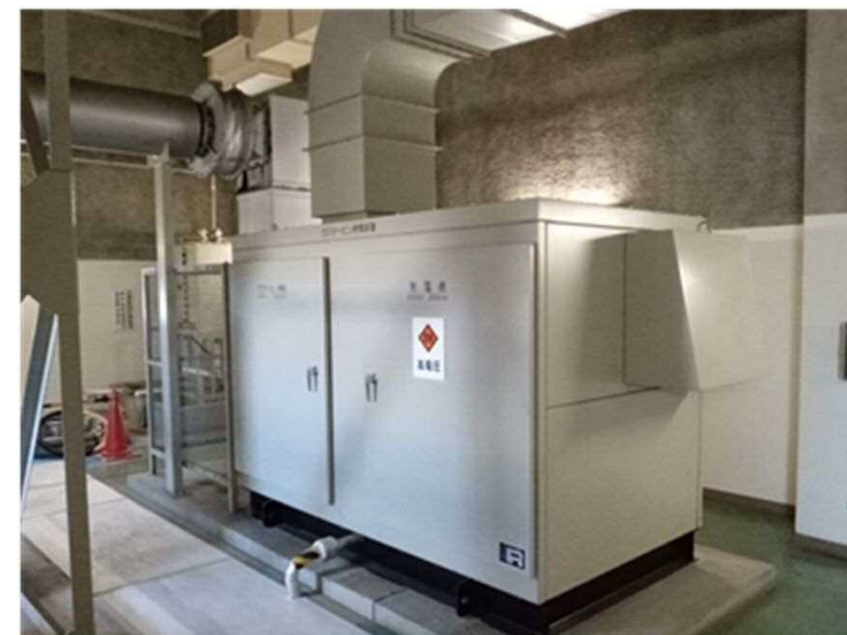
自家発電設備
