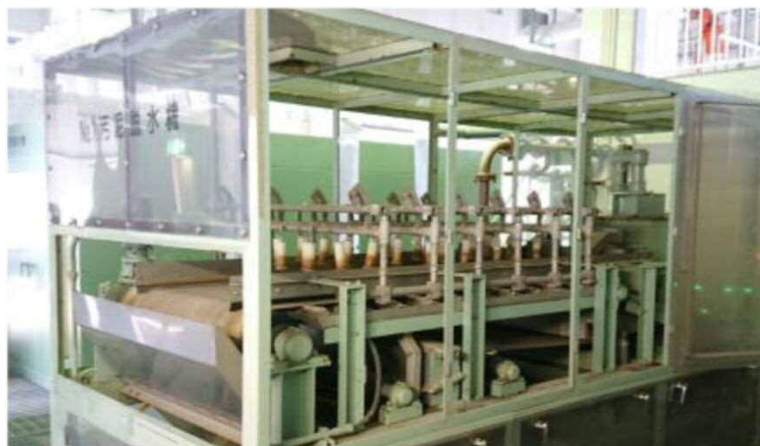
横手処理センター（横手市） 汚泥脱水機 平成元年設置（33年経過）
