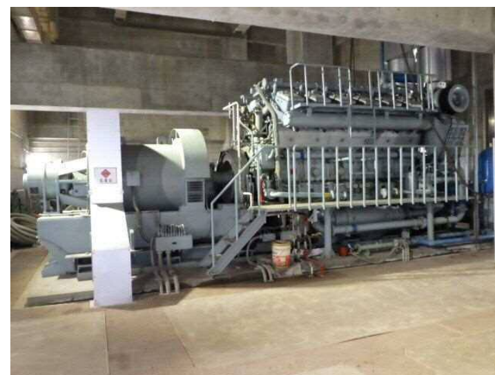
自家発電設備
