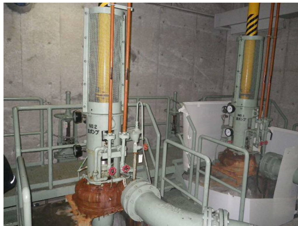
臨海処理区 飯田川中継ポンプ場（潟上市） No. 1、No. 2主ポンプ更新工事 平成2年設置（32年経過）
