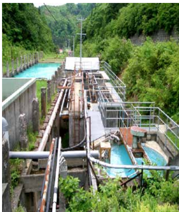
吉乃鉱山（横手市）坑廃水処理施設
