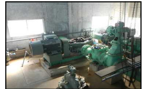
戸村揚水機 (五城目町)
