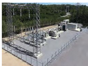
154kV受変電設備 県内風力発電所
