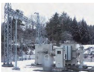
66kV受変電設備 県内水力発電所
