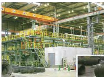
自動酸洗設備
