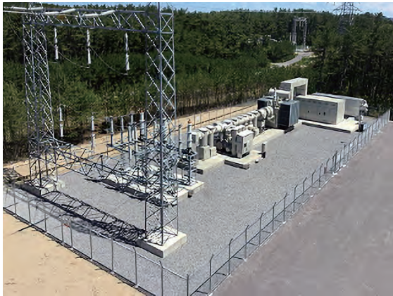
154kV受変電設備 県内風力発電所
