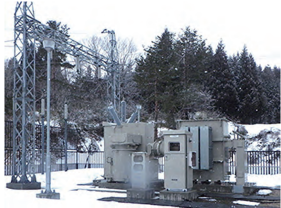
66kV受変電設備 県内水力発電所
