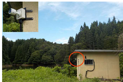
【ため池監視カメラ設置例（秋田市）】
