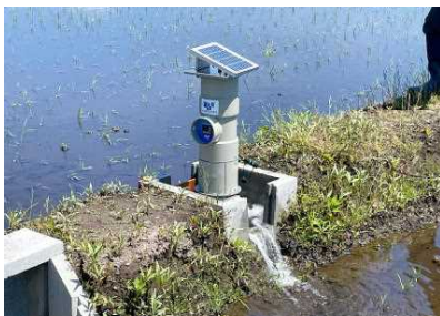
【自動給水栓によるICT水管理】
