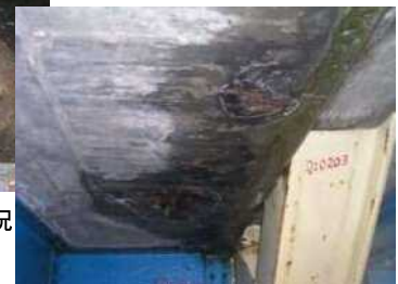
▼鉄筋が露出した床版
