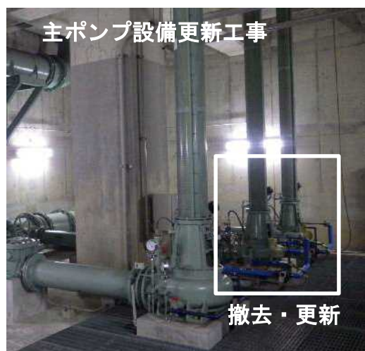
大曲中継ポンプ場（大仙市）
