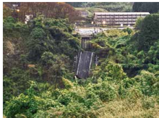
崩落した旧阿蘇大橋
