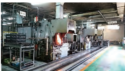
本社工場・熱処理設備
