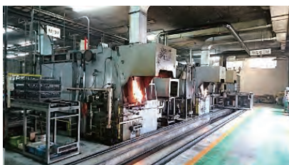
本社工場・熱処理設備
