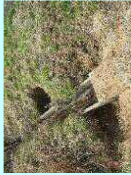
不具合箇所 (水路)
