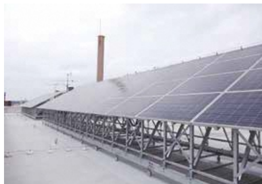
県庁舎に設置した太陽光発電設備
