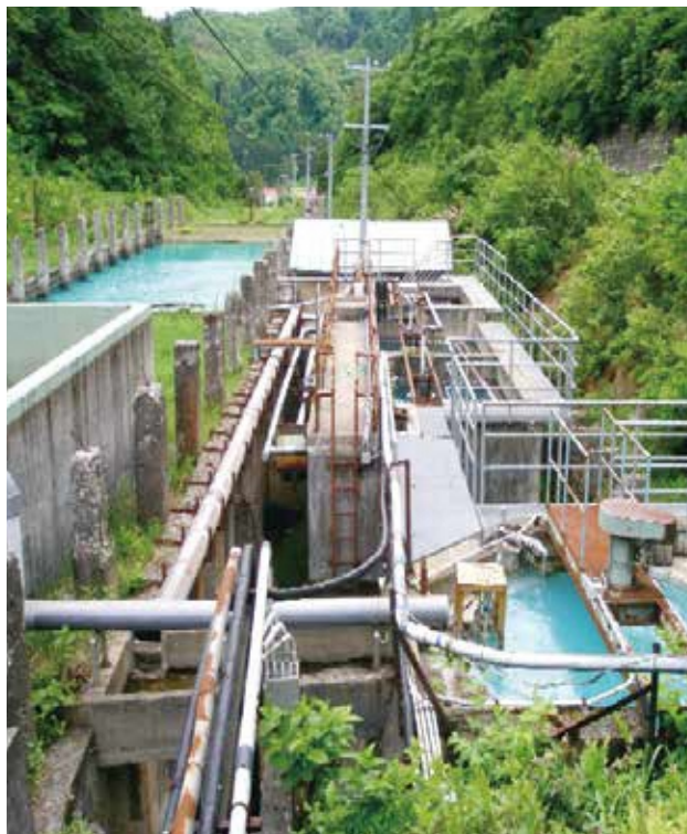
吉乃鉱山（横手市）坑廃水処理施設
