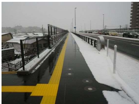
道路融雪設備
