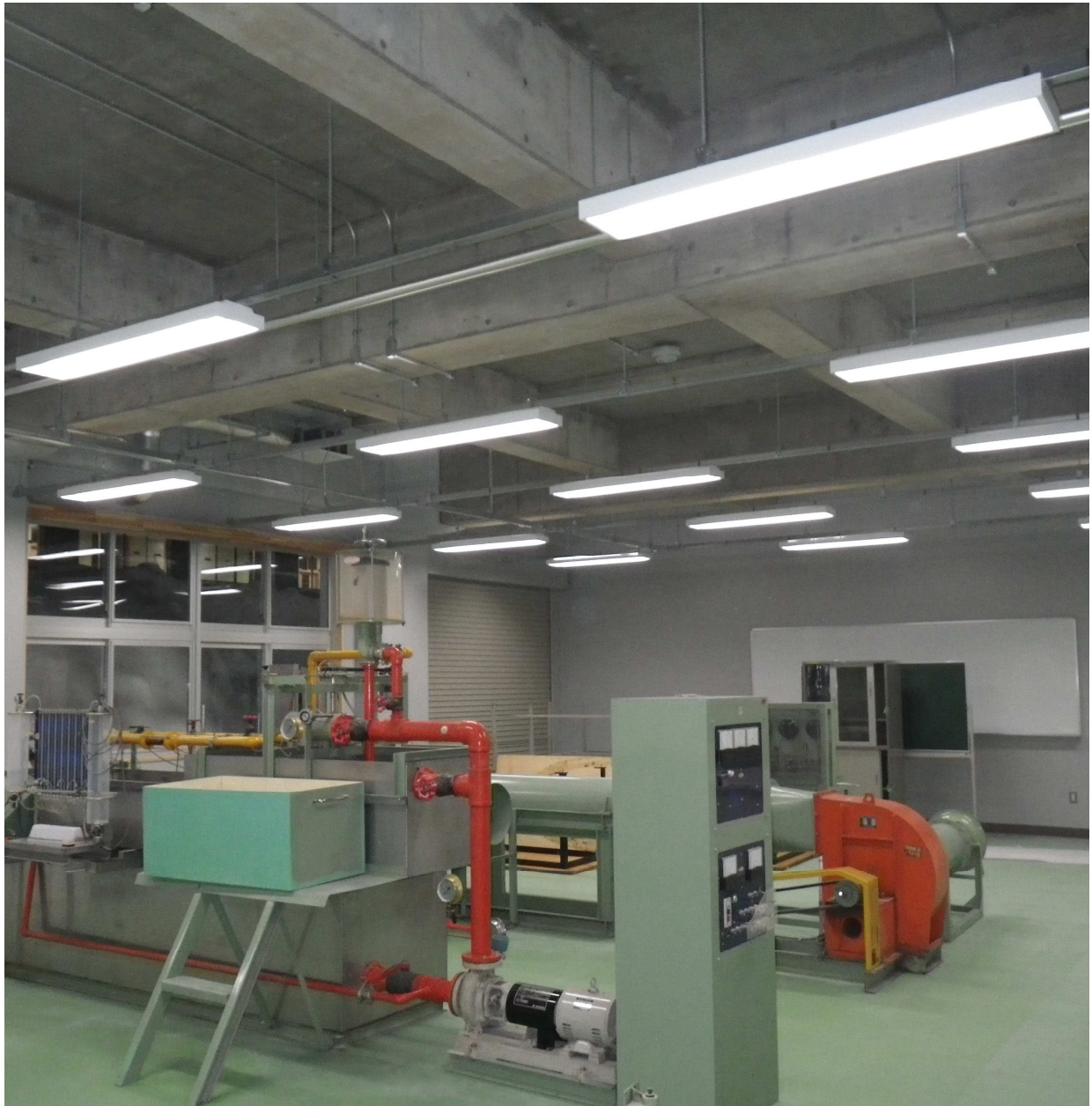
第35回秋田県優良工事表彰から 大曲工業高等学校実習棟電気設備工事 (大仙市大曲若葉町)
