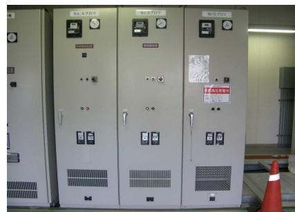
撤去予定の高圧盤を仮設設備として利用
