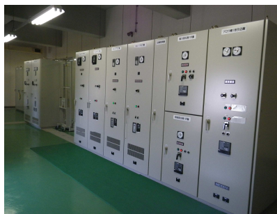
電気室(ブロワ棟1F) 【移設完成状況】
