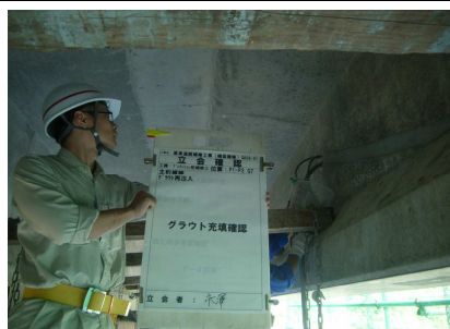
架設当時のグラウト不足が確認され再グラウトを追加実施
