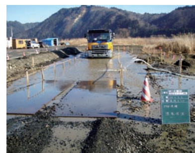
プール式洗浄設備
