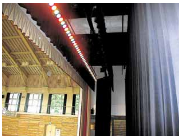
完成写真 (ステージ照明)
