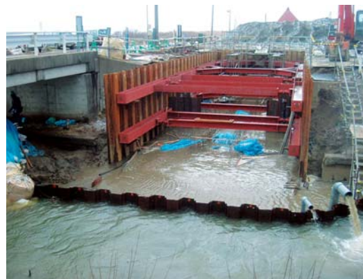
強風による冠水（仮締切矢板内）
