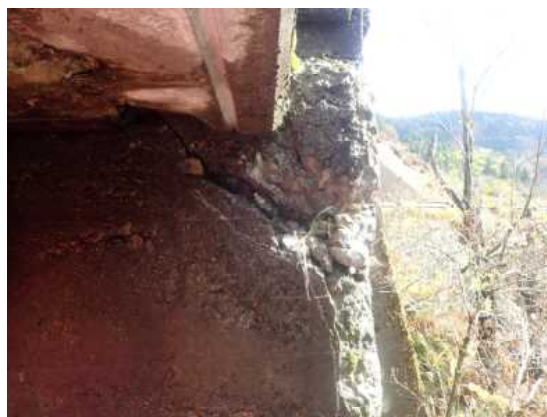
太良橋 破損状況
