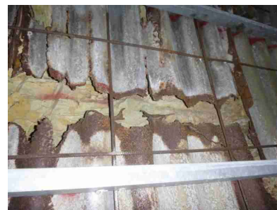
鋼材腐食状況
