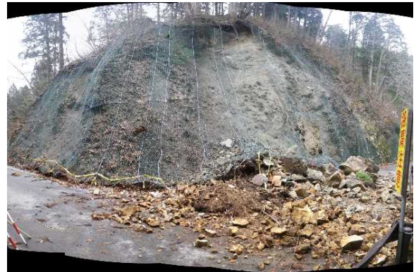
西目屋二ツ井線（落石状況）
