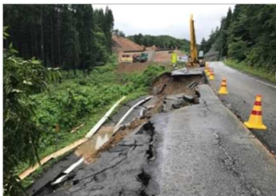
(H29.7 大雨被災状況)
