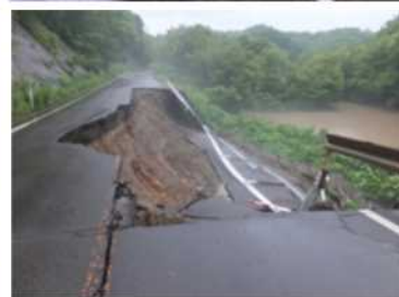
国道105号被災箇所
