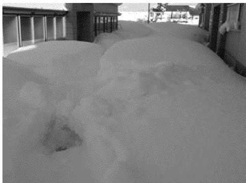
県営船場町住宅 (消雪設備の機能不良状況)
