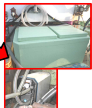
冷却水タンク&冷却装置
