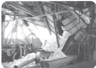
雪により倒壊した建物
