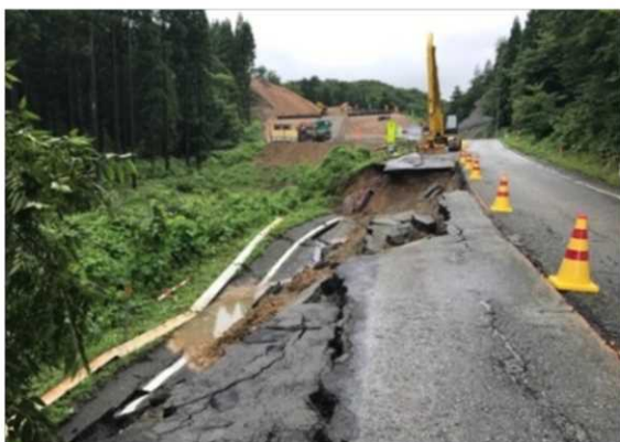
(H29.7 大雨被災状況)
