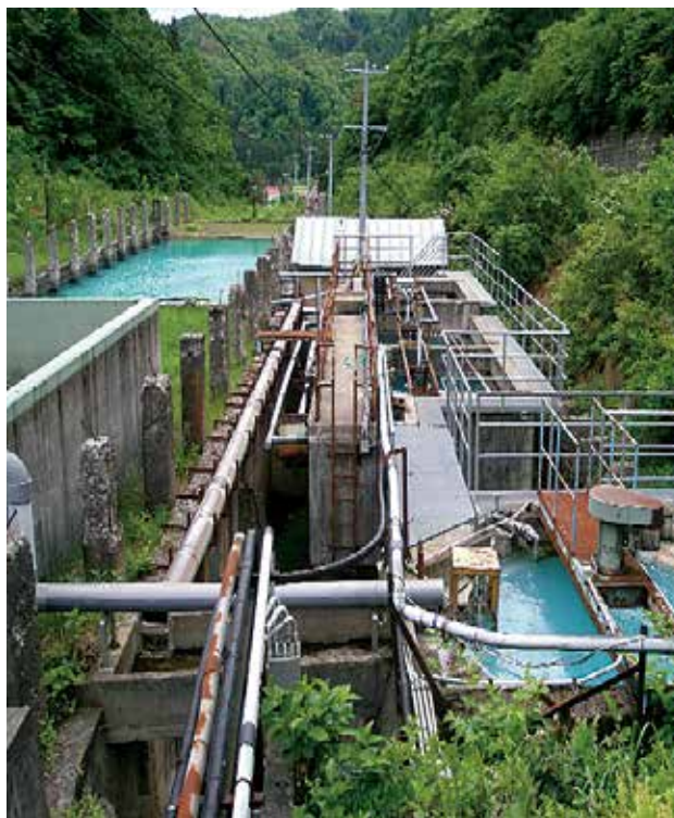
吉乃鉱山（横手市）坑廃水処理施設
