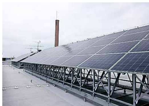
県庁舎に設置した太陽光発電設備
