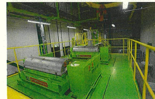
写真⑦ 発酵液脱水機
