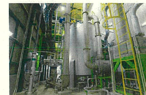
写真⑧ 汚泥乾燥機
