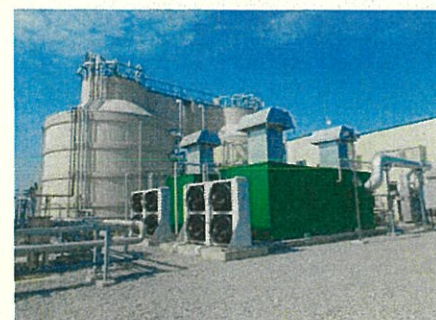
⑥ ガス発電機
