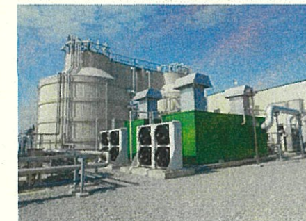
写真⑥ ガス発電機
