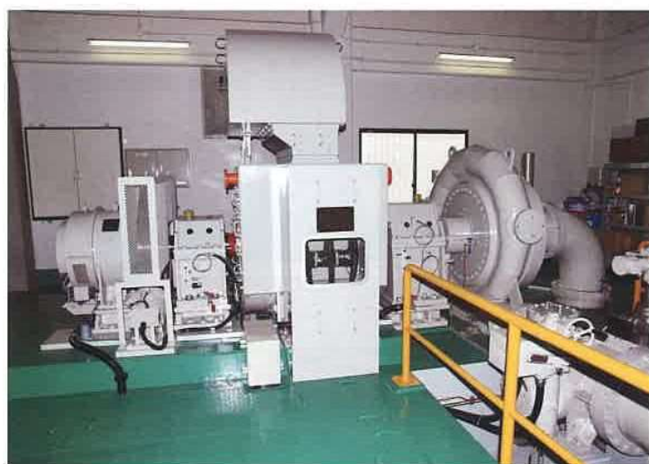
1階 水車発電機室
