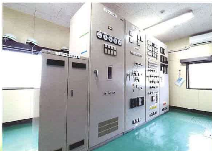
2階 監視制御室
