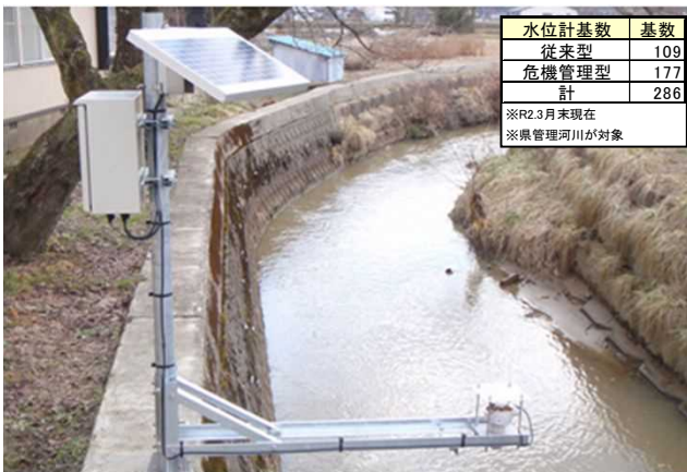
図 危機管理型水位計の例
