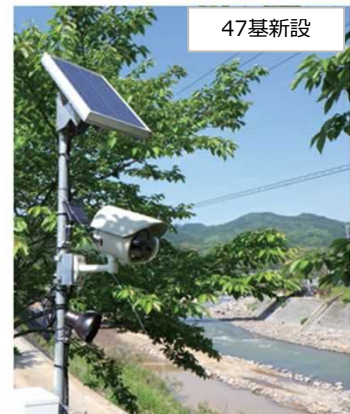
図 河川監視カメラの例
