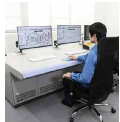
中央監視室 汚泥搬入から資源化物搬出まで施設内の全設備を監視・操作します。
