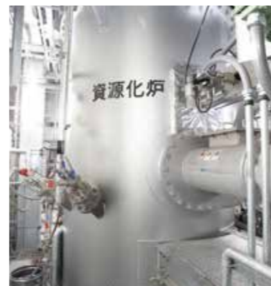
資源化炉 汚泥を約780℃の高温で熱分解し、資源化物(炭化物)を製造します。
