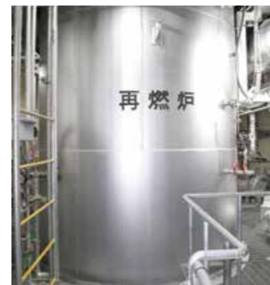
再燃炉 資源化炉から排出される熱分解ガスと乾燥ガスを約900℃の高温で完全燃焼させ、未燃分を分解してN 2 O*排出量を低減させます。 *N 2 O:一酸化二窒素の略。CO 2 の298倍の温室効果があるガス。
