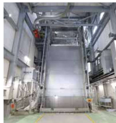
汚泥受入設備 秋田県北部の3市3町1組合からの汚泥を集約して受け入れます。
