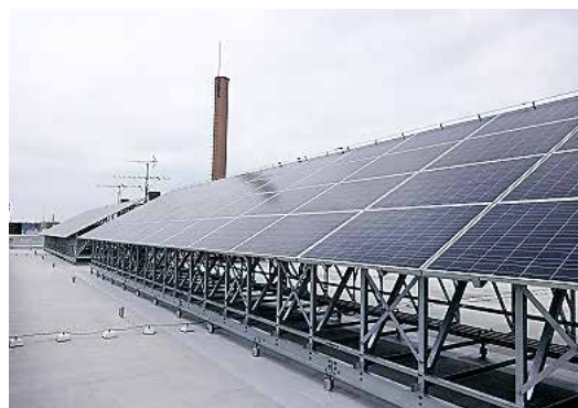
県庁舎に設置した太陽光発電設備
