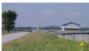
幹線用水路の不同沈下
