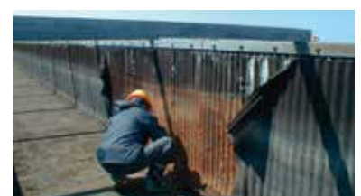
腐食が進む幹線用水路
