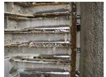
シリンダーゲート腐食状況
