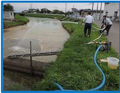
ポンプ放水 小深見川 (H27. 9. 1)
