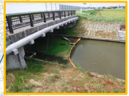
アオコ遡上防止フェンス 糸流川 (H30. 8. 15)
