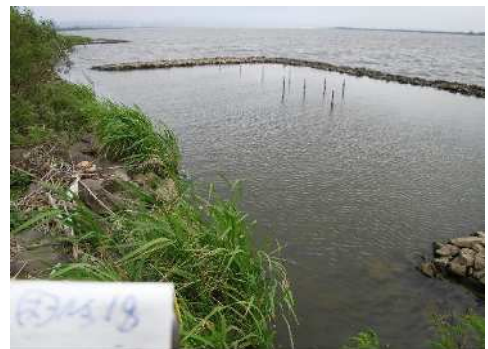
植生が回復していない消波工
